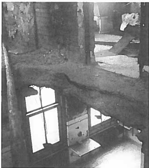
Innenansicht des zerstörten Gebäudes
